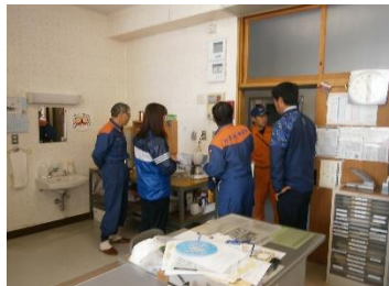
警報機点検（職員室）
